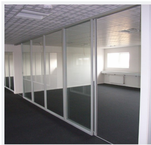
Glasvæg med skydedør
